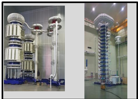
AC共振試験システム 500kV 50A (2本の並 列タワー)
