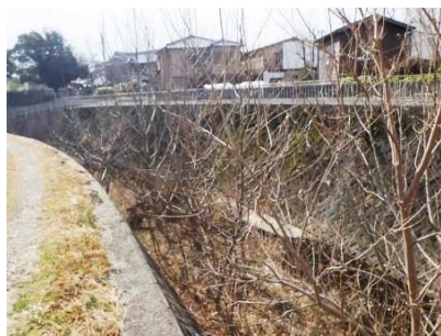
雑木が繁茂する河道
