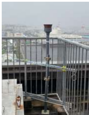
縦型オールインワン型 IoT 降雨計（設置）
