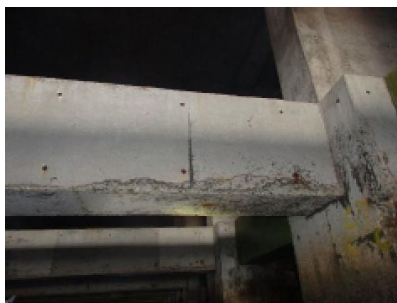
複数のひび割れ
