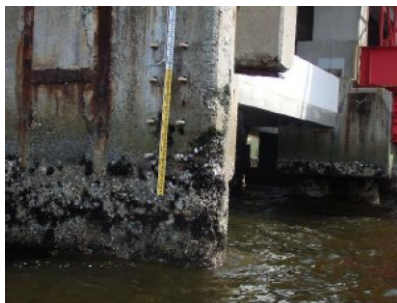
欠損・ひび割れ
